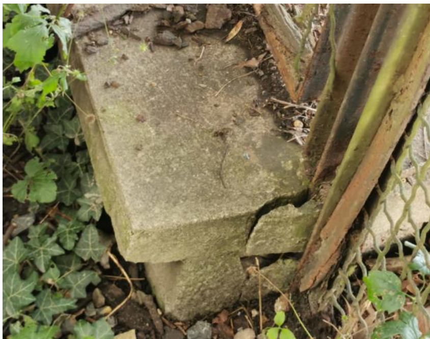
Fot.8– odspojenie betonu
