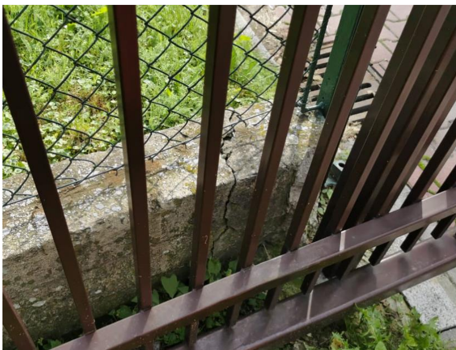
Fot.5 – pęknięcie ogrodzenia przy gruncie
