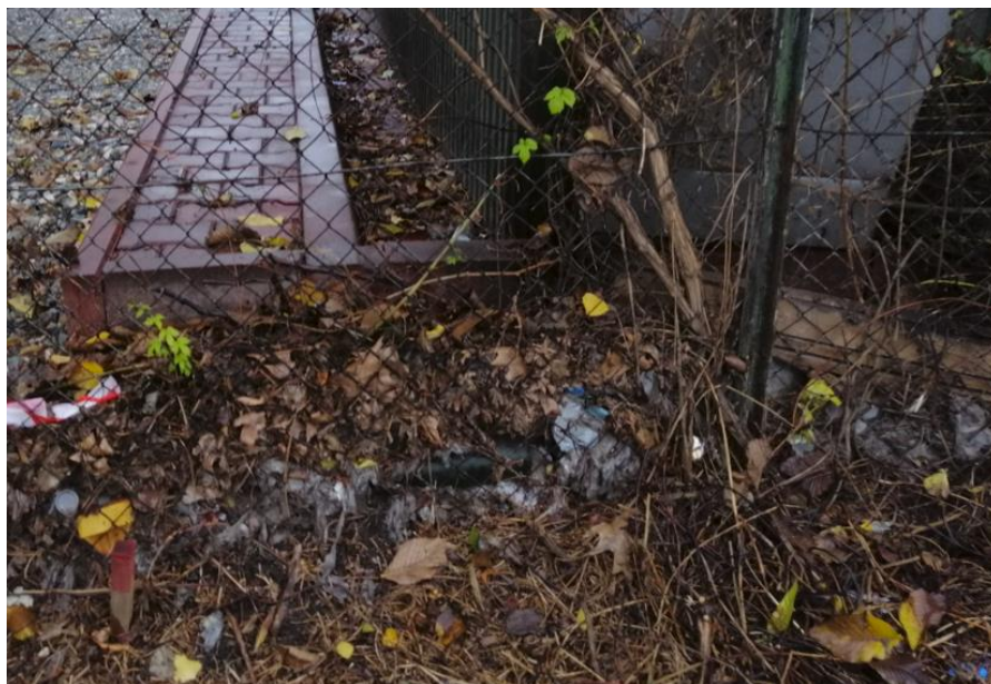
Fot.4 – degradacja ogrodzenia przy gruncie
