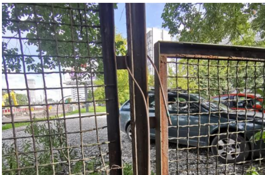
Fot.7– korozja elementów stalowych
